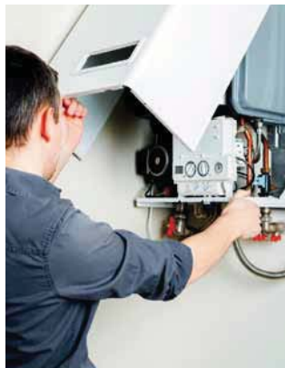
Pulizia periodica della caldaia da parte di un tecnico specializzato
